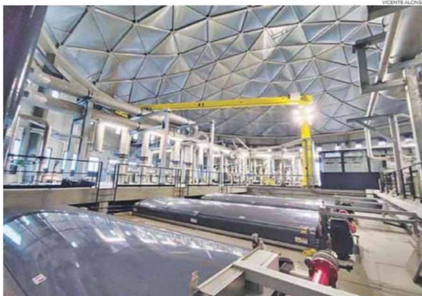
El nuevo edificio central de la potabilizadora, con los sistemas de microfiltración y ultrafiltración.
