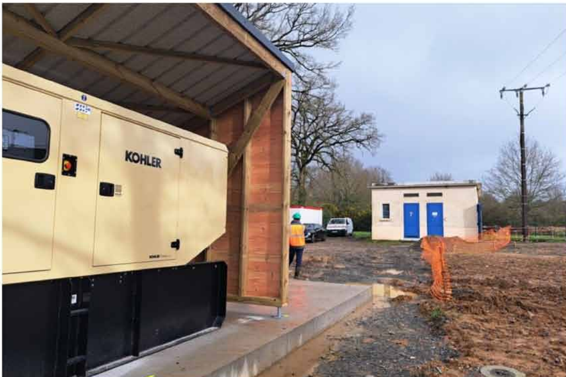
Un groupe électrogène qui permet de ne pas avoir de coupure dans le pompage de l'eau à l'usine de Trigodet
